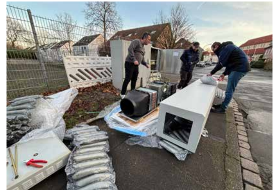
Installation aktives Kühlsystem
